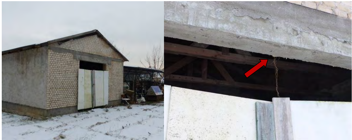
Abb. 24: Nebengebäude mit Einflugsmöglichkeit (links) über der Tür und einem alten Nest eines Hausrotschwanzes über dem Türsturz (rechts)
