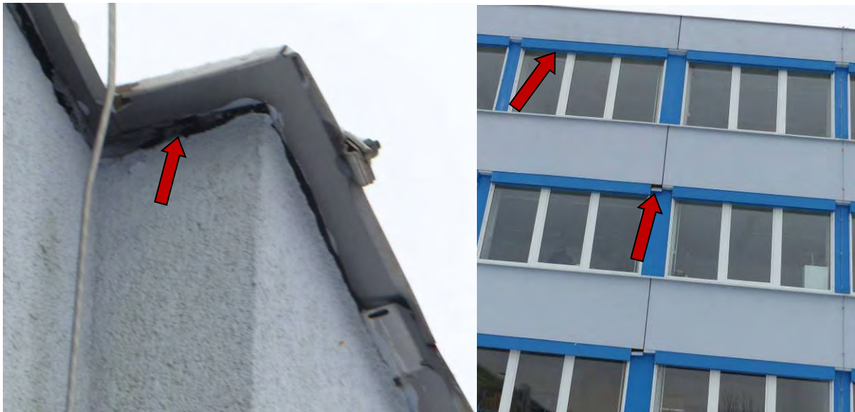
Abb. 20: Potentielle Spaltenquartiere an der Westseite des Bildungszentrums unterhalb des Dachbleches (links) sowie an der Südseite hinter der abgelösten Verkleidung bzw. in den Rollladenkästen (rechts)
