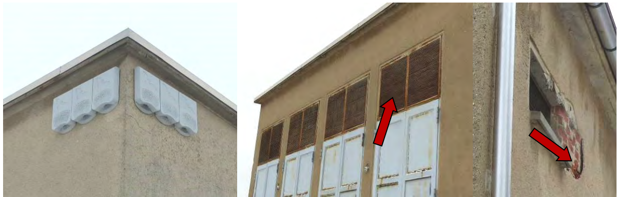
Abb. 16: potentielle Habitate am Trafohaus: 6 Fledermauskästen (links), Lüftungsschlitze (Mitte) und Spalte hinter abgebröckeltem Putz (rechts)
